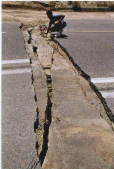
a. Route de Californie après le séisme du 28 juin 1992.
